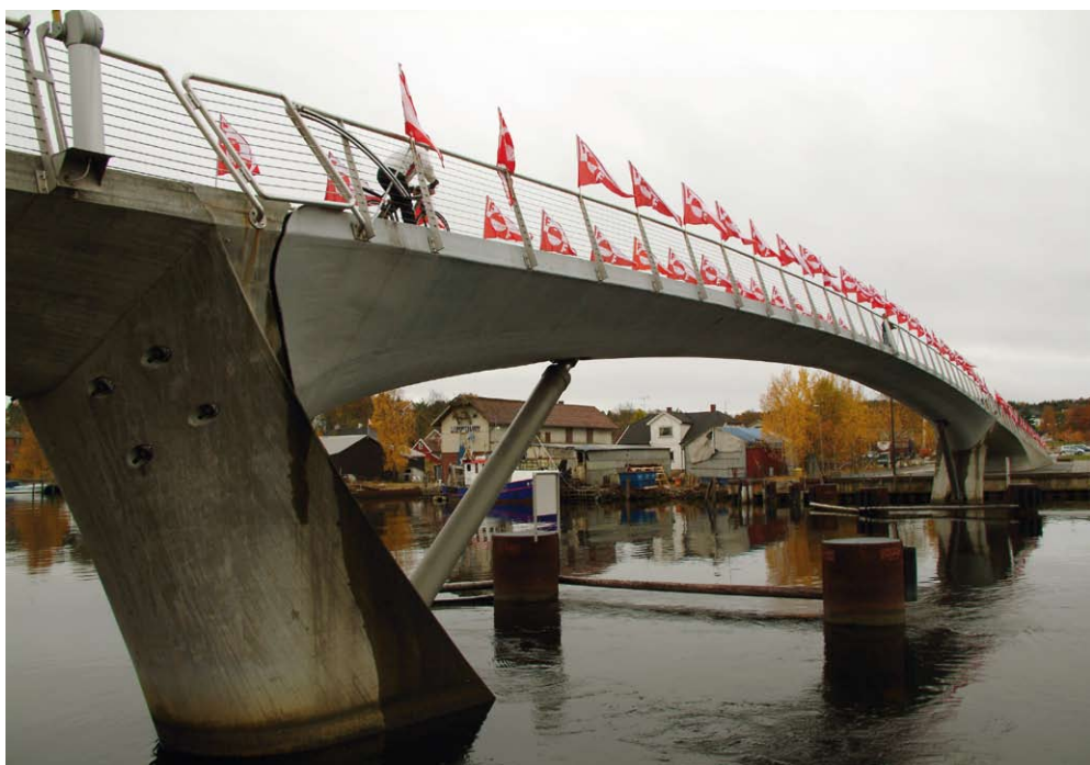
Gangbroa i Fredrikstad , laget i komposittmaterialer, er blitt et kjent trekk i bybildet. Slik kan den fremstå når byens storhet, Fredrikstad Fotballklubb, har hjemmekamper. Foto: Jon Hermansen.
